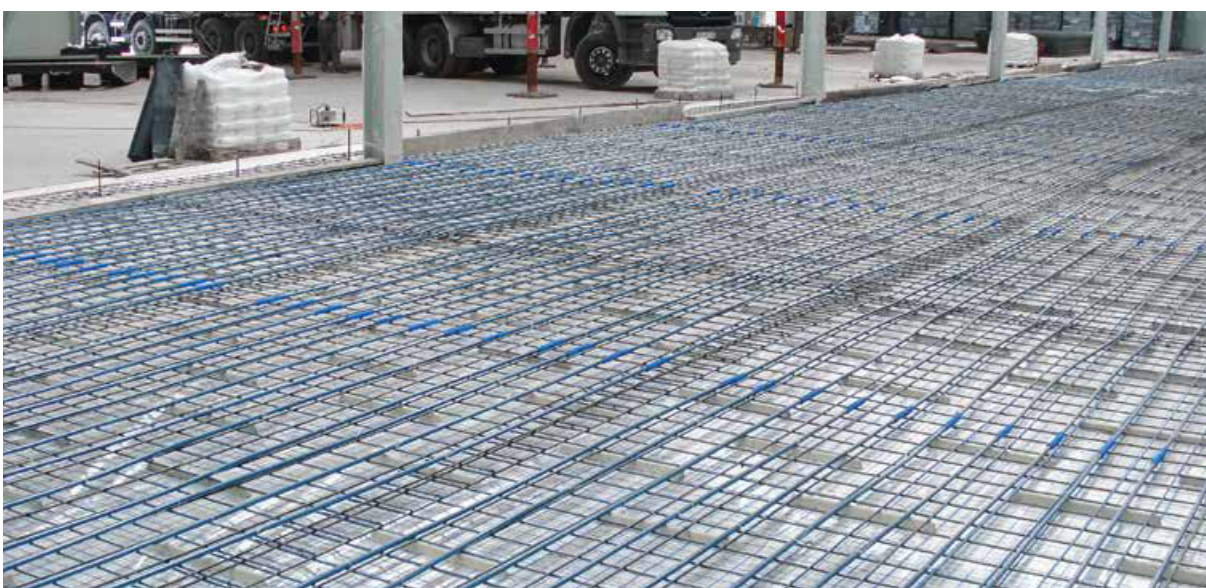
Fig. 4. Instalație de încălzire prin pardoseală într-o unitate industrială, realizată cu ajutorul țevilor bluePERT și a sistemului KAN-therm NET.
