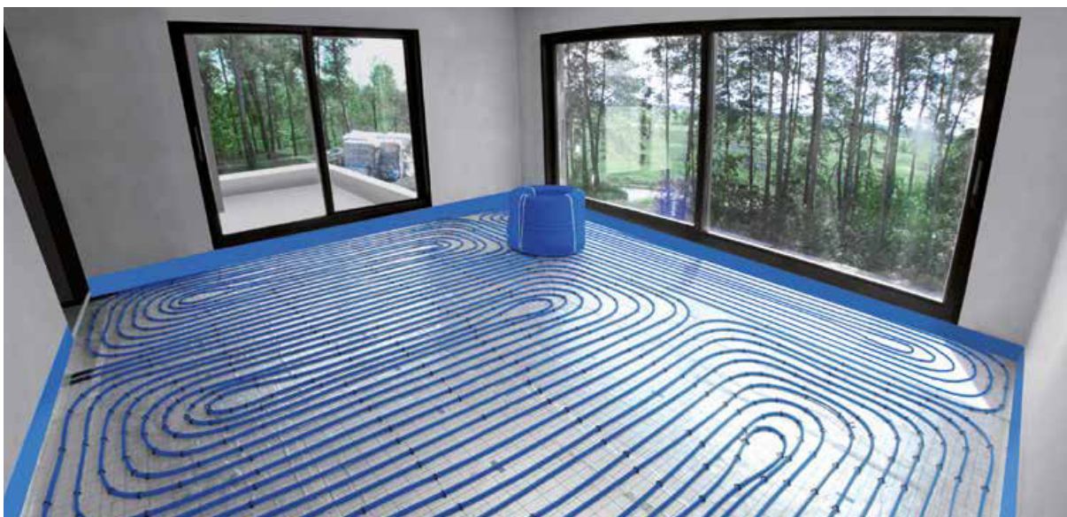
Fig. 3. Instalație de încălzire prin pardoseală într-o clădire unifamilială, realizată cu ajutorul țevilor bluePERT și a sistemului KAN-therm Tacker.
